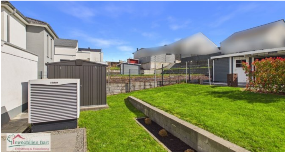
Wärmepumpe und Gartenhaus
