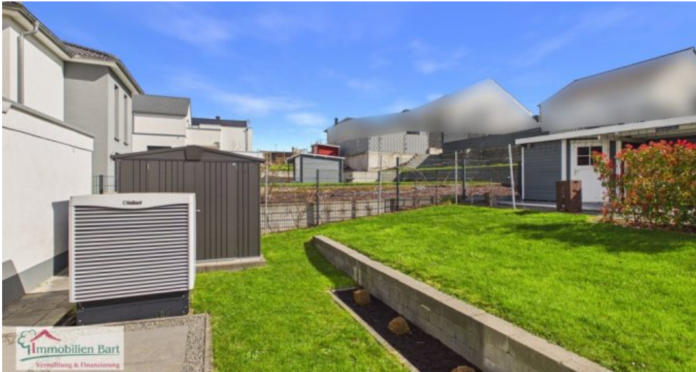
Wärmepumpe und Gartenhaus
