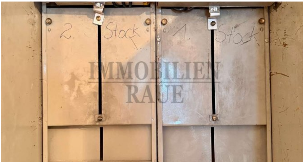
Stromsicherungskasten im OG
