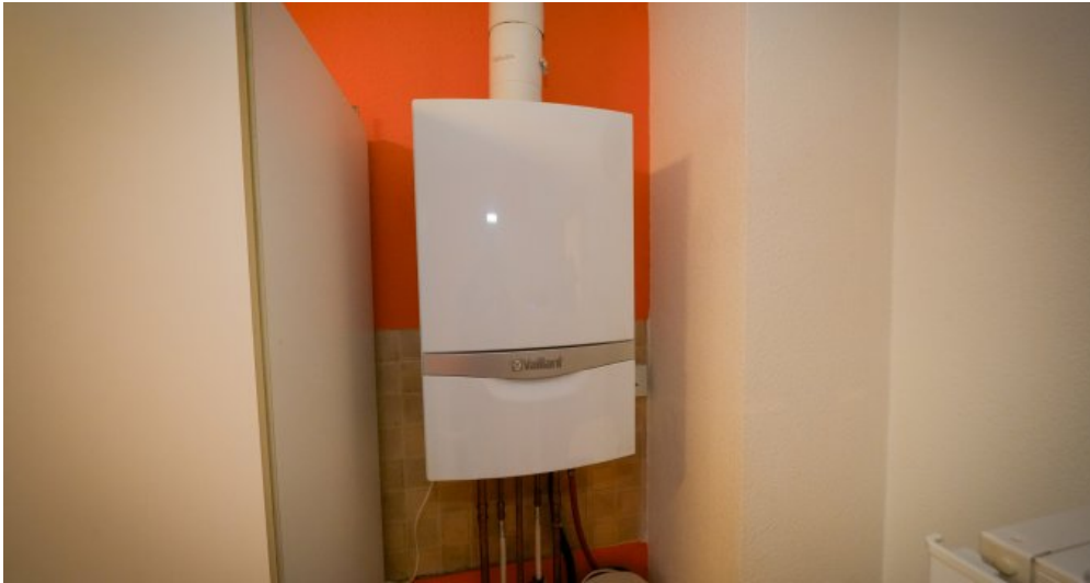
Heizung für DG
