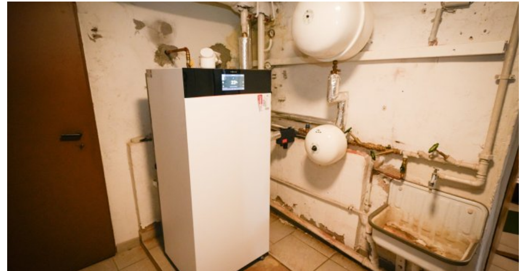
Heizung für EG und 1. OG
