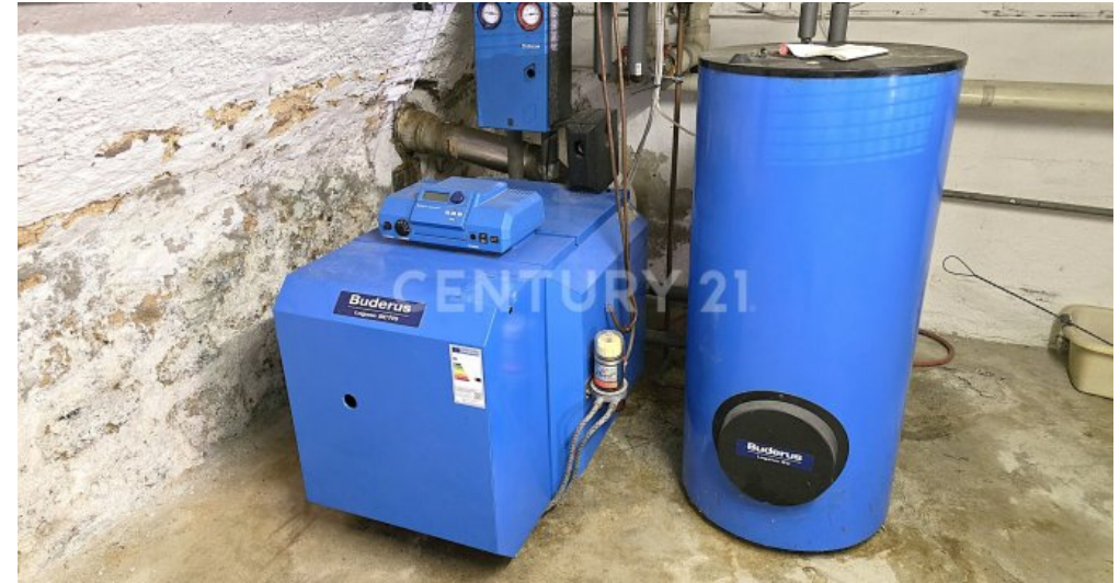
Öl - Zentralheizung Buderus mit Warmwasserspeicher Bj. 2005
