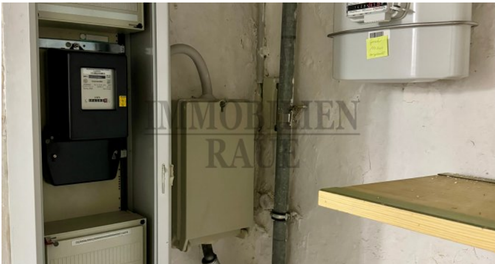
Strom- und Gaszähler
