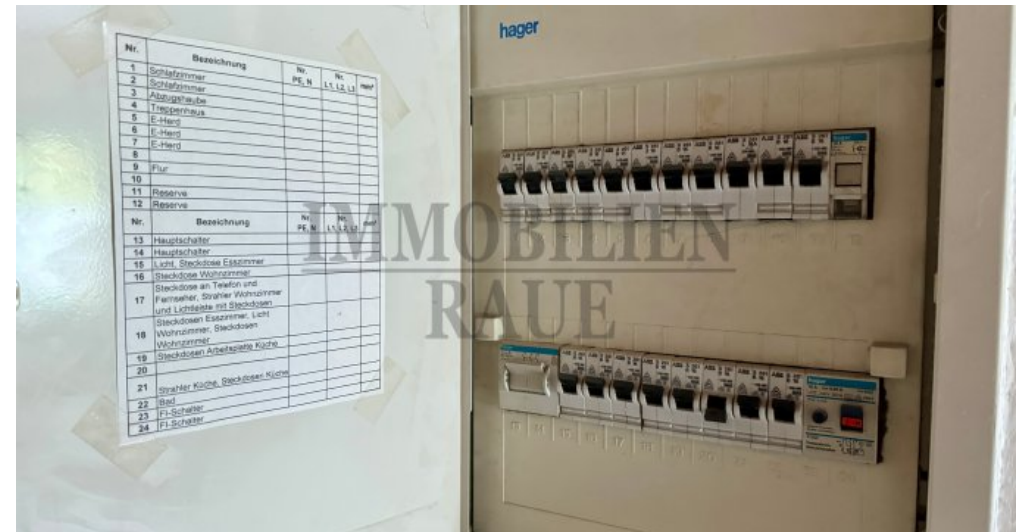
Strom Unterverteilung OG+DG (im OG)
