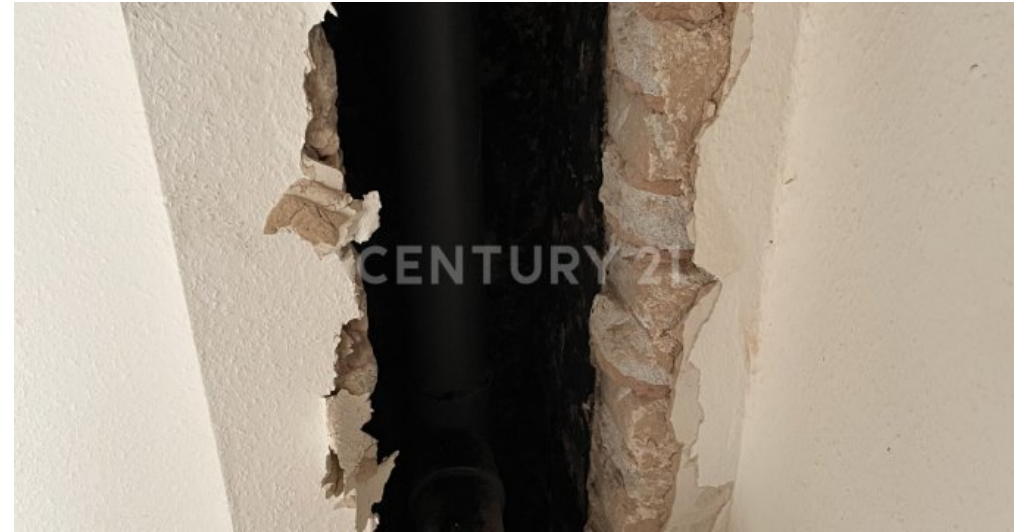
Badumbau nicht abgeschlossen
