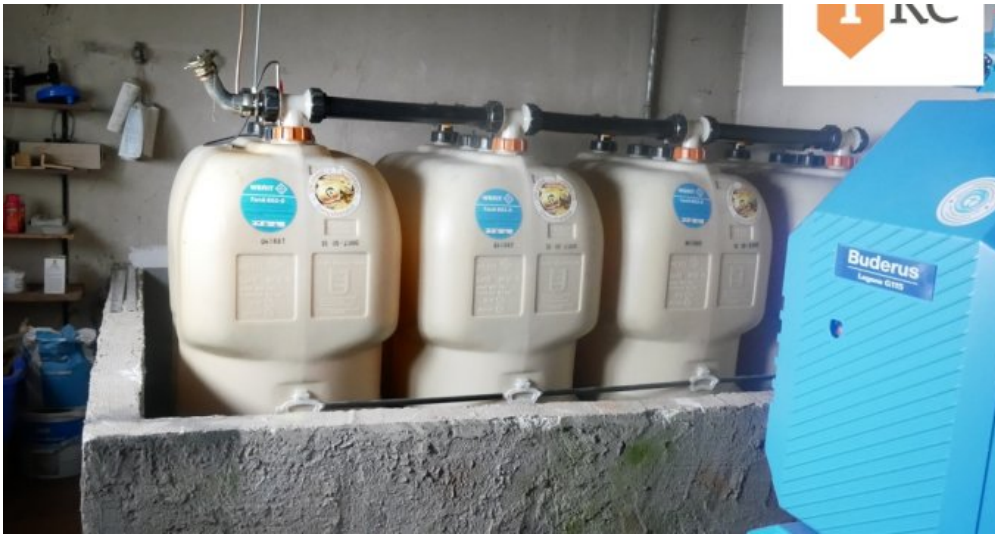
Heizungs- und Tankraum
