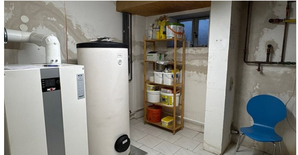
Neuwertige Heizungsanlage UG
