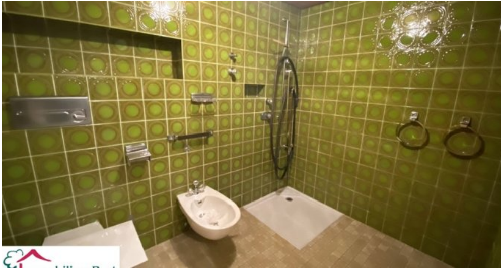
Schwimmbereich: Dusche + Sanitär
