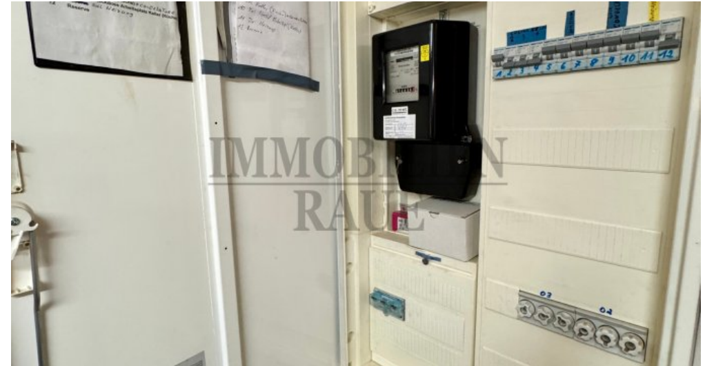
Stromzählerschrank (im KG)
