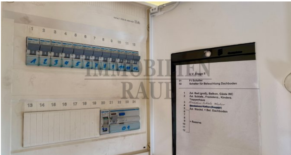
Unterverteilung (im OG)
