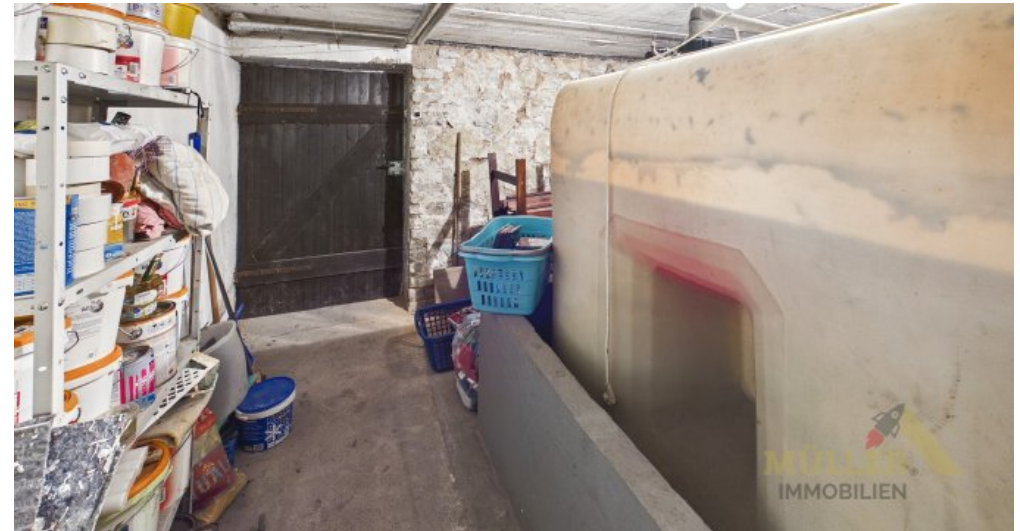
Öltanks und Abstellraum
