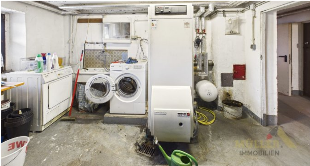
Heizungsraum und Waschküche
