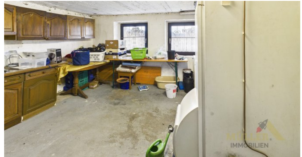
Heizungsraum und Waschküche
