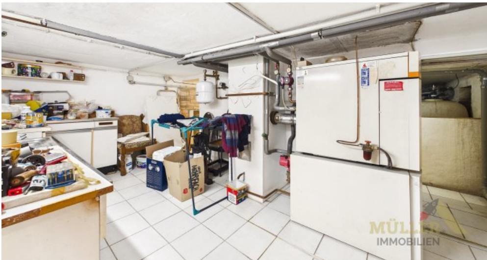
Allzweckraum 1 mit Heizung
