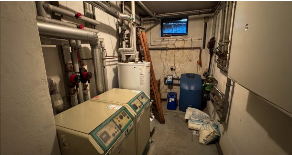
Heizraum mit Etagenheizungen im KG
