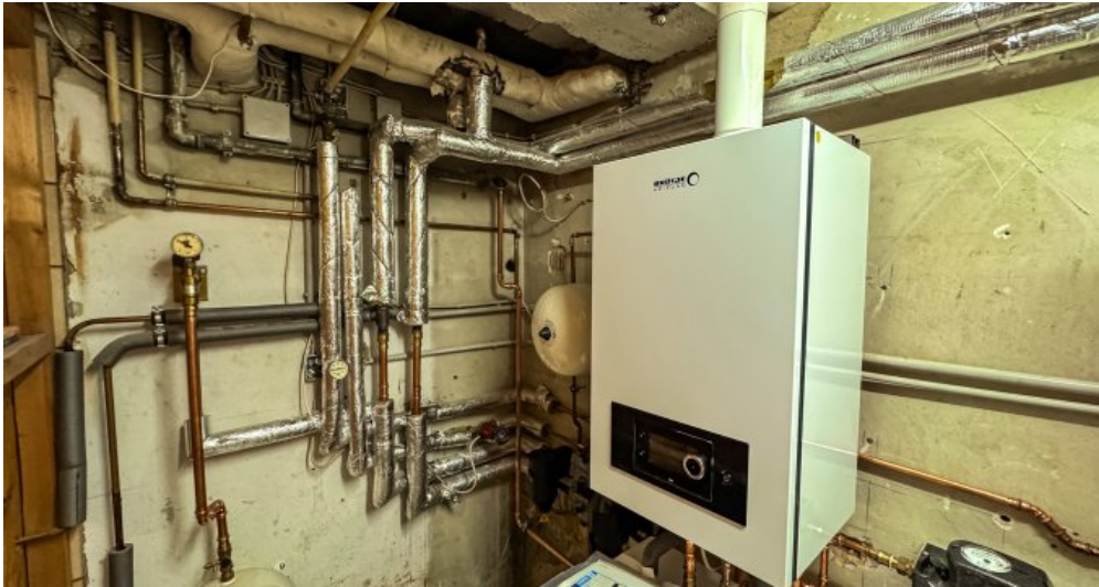
Gas- Brennwertheizung Bj. 2025 Brötje
