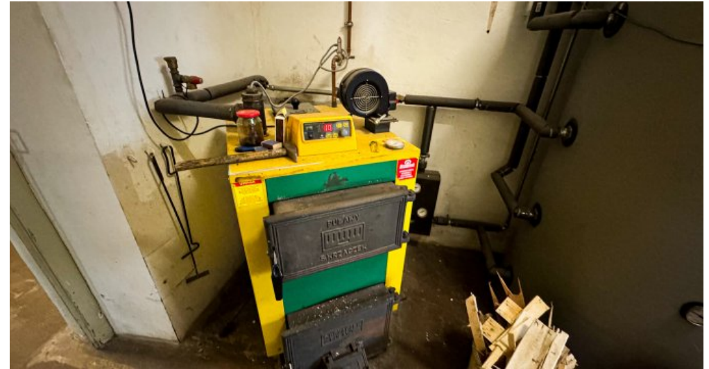
Allesbrenner mit Warmwasserspeicher
