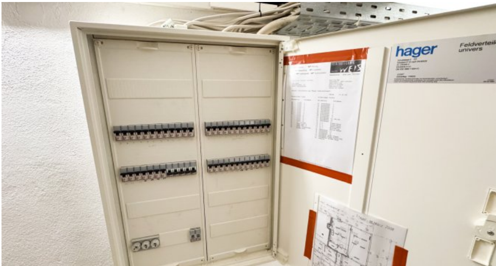
Unterverteilung Strom Büro
