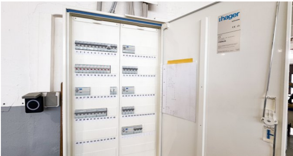
Unterverteilung Strom Halle
