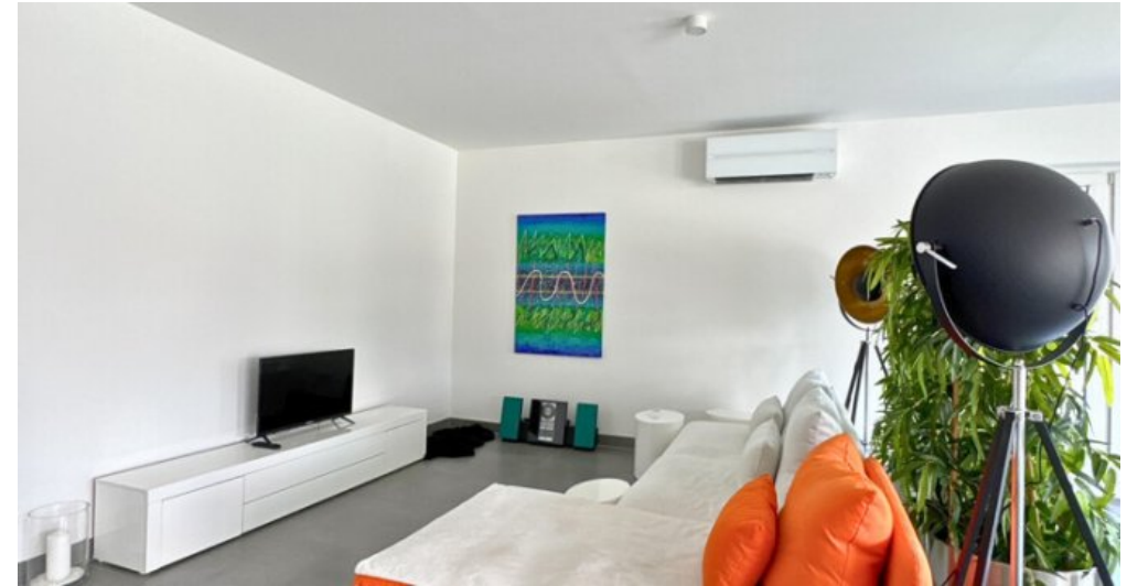
Wohnbereich mit Klimaanlage
