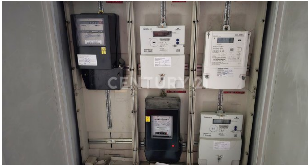
Zählerschrank im Erdgeschoss
