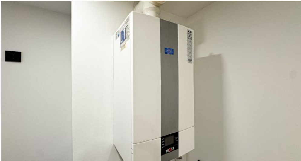
Gas Brennerheizung Fa. Wolf
