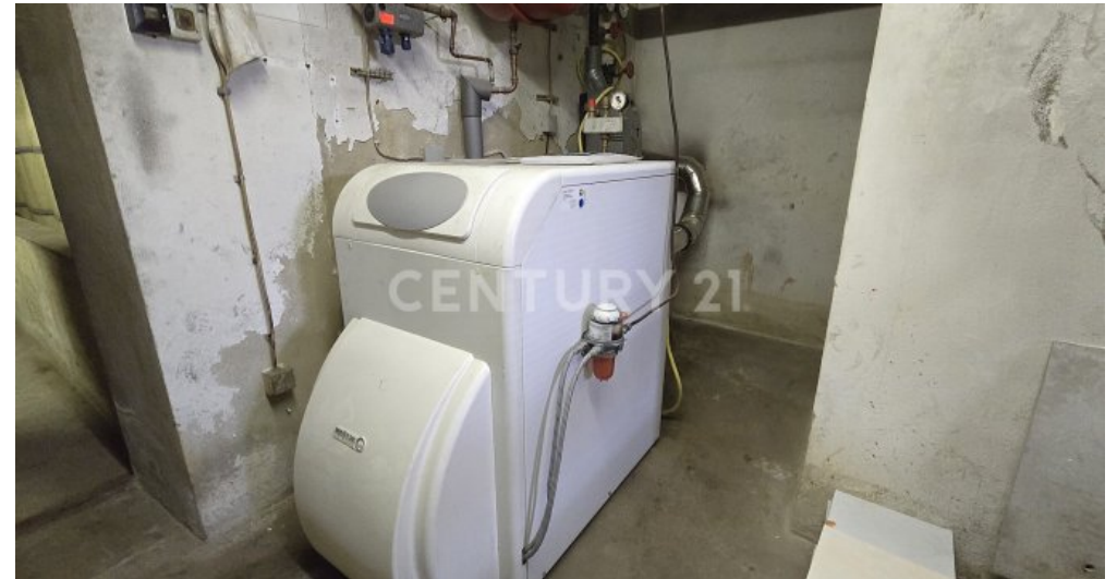
Neuwertige Öl - Zentralheizung Bj. 2012
