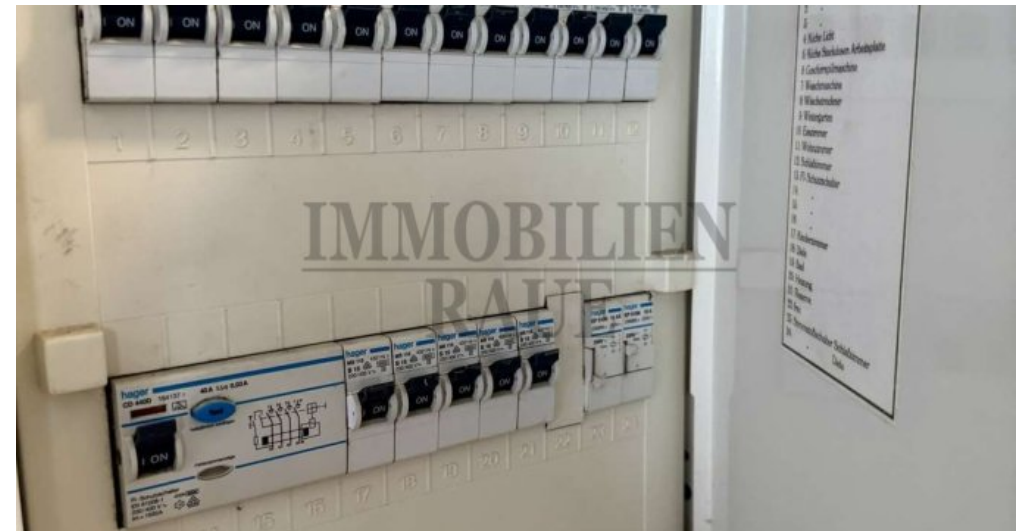
Whg. im 2. OG: Stromunterverteilung
