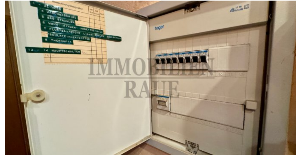
Whg. EG: Stromunterverteilung
