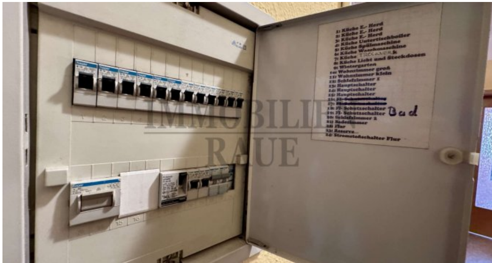
Whg. im 1.. OG: Stromunterverteilung
