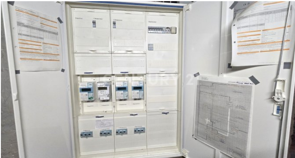
Neuer Zählerschrank im Keller
