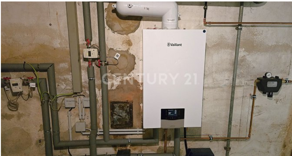
Neuwertige Vaillant Heizung für das OG und DG mit Durchfluss
