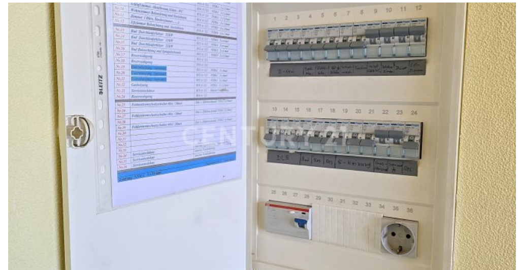
Neue Unterverteilung im Haus
